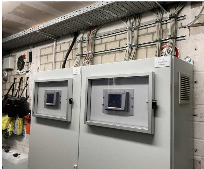
Steuerung der Heizungs- und Lüftungsanlagen
