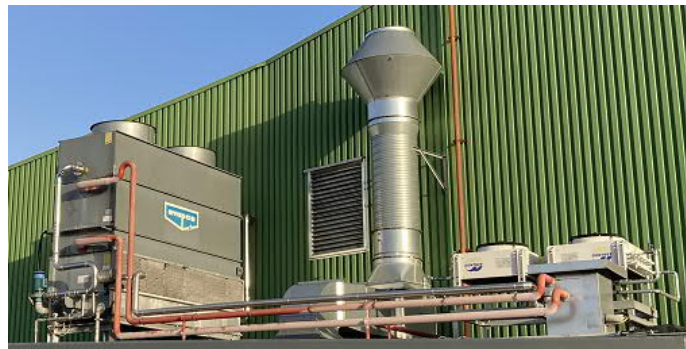
Rückkühler der NH 3 - Kältemaschine
